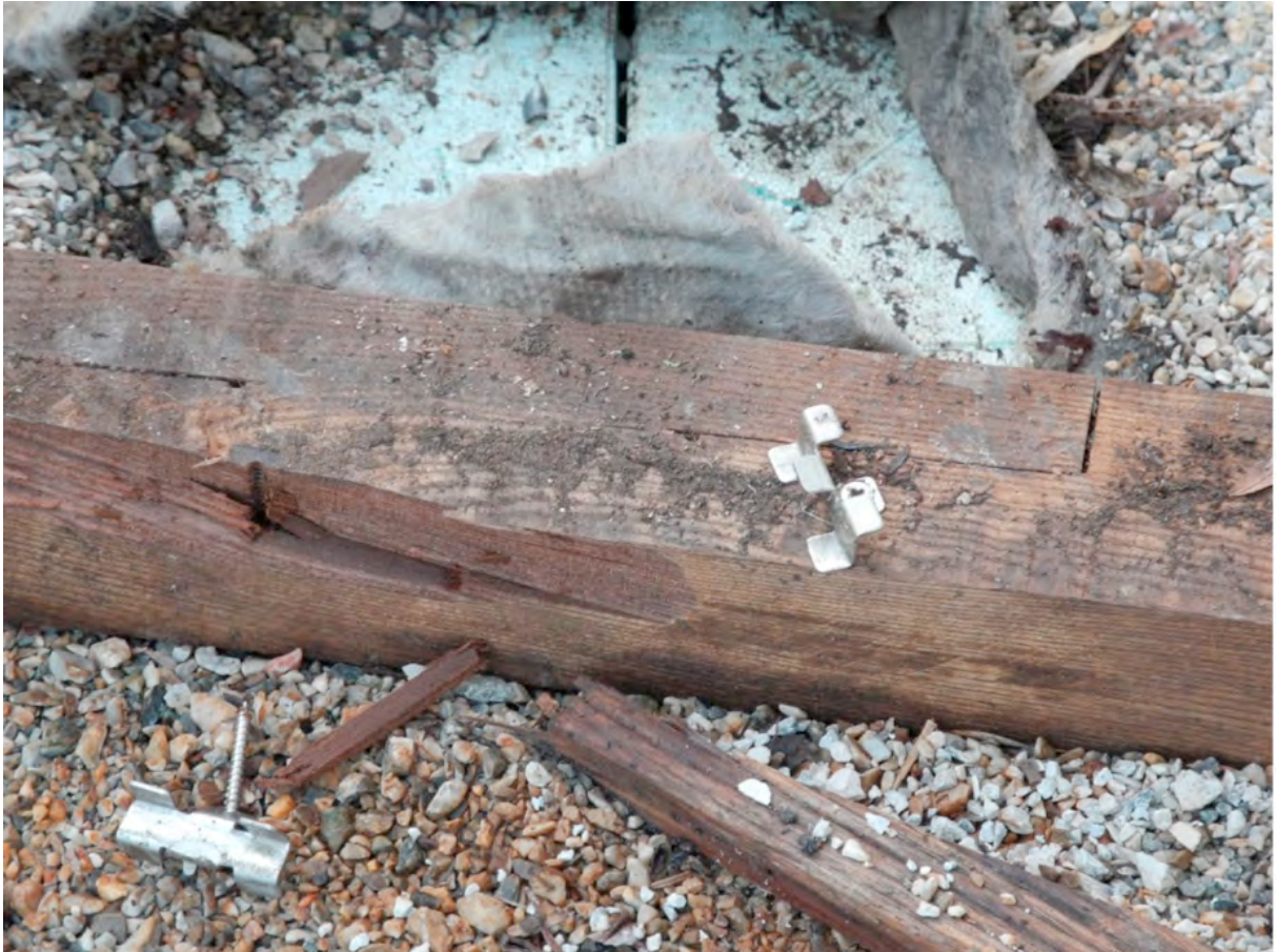
Vermorschung der Unterkonstruktion
