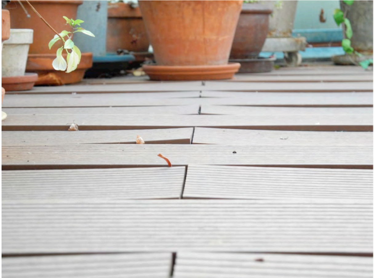
Deformierung der Terrassendielen
