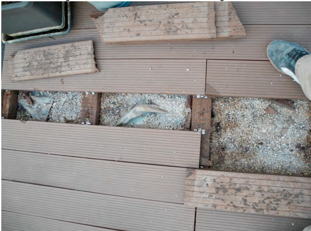
Schimmelbildung auf der Unterseite der Dielen
