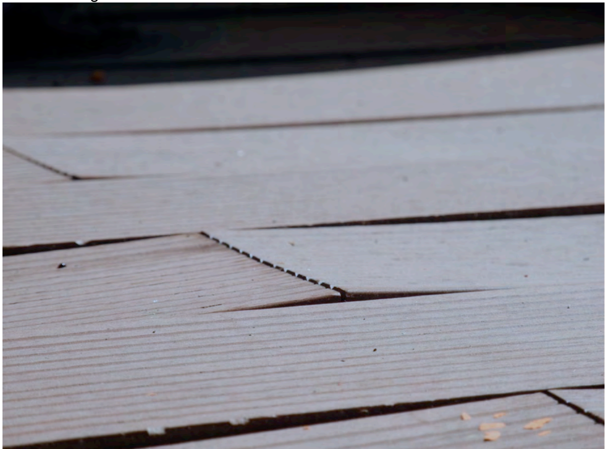
Deformierung der Terrassendielen
