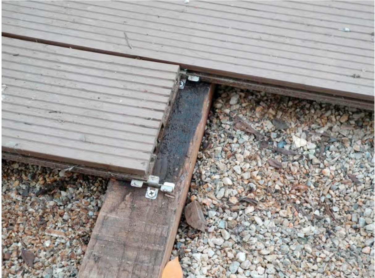
Stehende Feuchtigkeit nach Öffnen der Terrasse – Wetter regenfrei!
